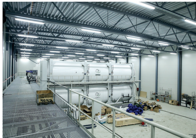
Fra innsiden av anlegget der det til sammen er 16 reaktorer for om-danning av råstoff av matavfall, fiskeavfall og kumøkk til biogass. Antec Biogas er både utstyrsleverandør og hovedeier av anlegget.
