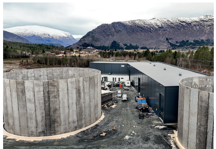
Anlegget til Vest Biogass sett fra øst i retning Grodås sentrum som ligger bak åskammen til venstre, cirka fire kilometer unna.
