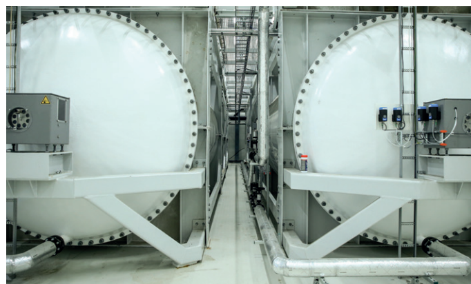
Hver reaktor veier 40 tonn. Gulvene er fiberarmerte, overflatebehandlede betonggulv.
