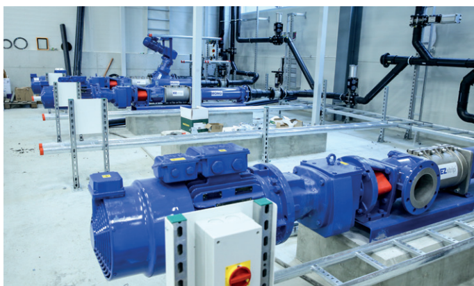
Pumpesystemer inne i bygget som skal sørge for fremdriften i prosessen med å skape biogass av matrester, kumøkk og fiskeavfall.
